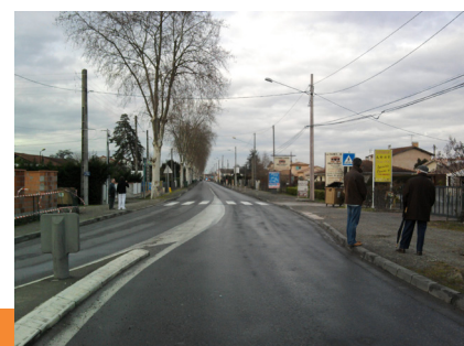
Rupture canalisation de gaz 15/03/2010
