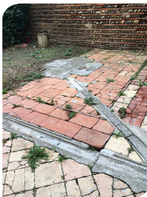
Pavage en carreaux qui doit être remplacé et vue de l'emplacement du puits à restituer
