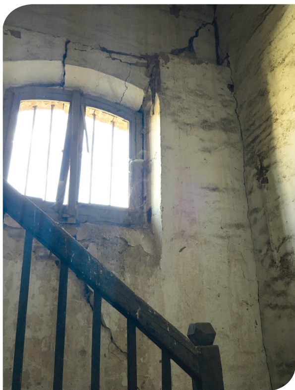
Fissures lézardant un mur extérieur fragilisé
