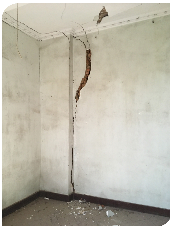
Fissure de mur porteur intérieur
